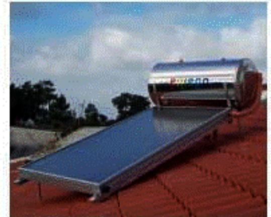
Instalação solar com termo-sifão STS
